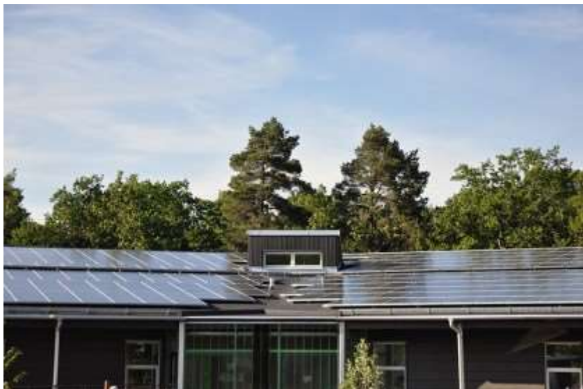
Taket täcks av 1300 kvadratmeter solceller och förser skolan med all energi som krävs.
