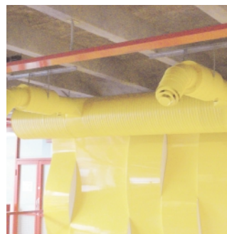
BILD 10. Ventilationskanal i en restaurang (Kv. Garnisonen, Stockholm)
